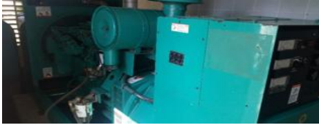
Figura 8. Características planta eléctrica
