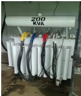
Figura 5. Características del transformador 200 kVA
