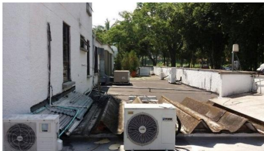
Figura 70. Aires acondicionados afectados por radiación solar
