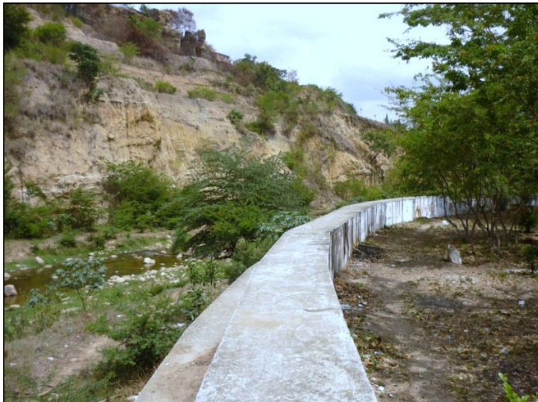
Foto 9 Erosión en surcos y cárcavamiento sobre los taludes localizados sobre la margen izquierda del río de Oro, frente al barrio Santa Cruz de Girón
