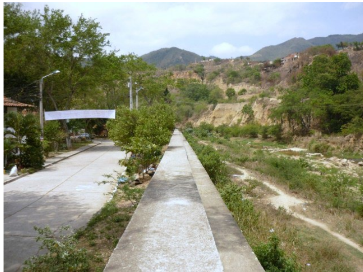
Foto 18 Dique lateral en gaviones revestidos, para evitar desborde del río de Oro, zona urbana de Santa Cruz, Girón
