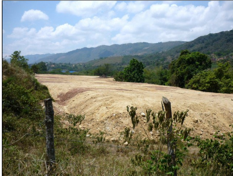
Foto 20 Llenos compactados, en la zona industrial, margen derecha del río de Oro
