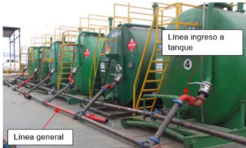
Fotografía 33. Ejemplo de interconexión de tanques con tubería de golpe.
