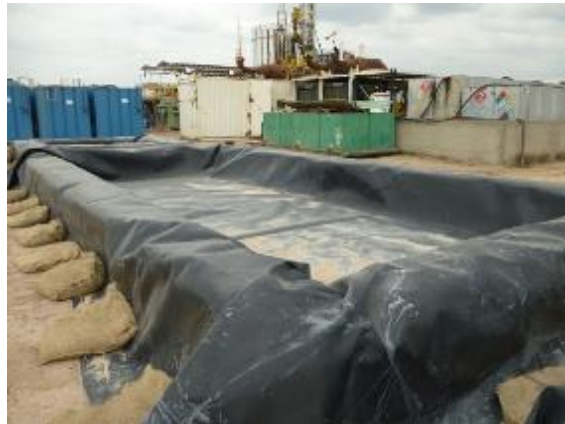
Fotografía 26. Dique para el área de generación eléctrica.
