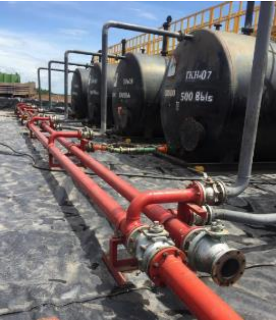
Fotografía 35. Ejemplo de cabezales y líneas de entrada a tanques, prefabricadas.
