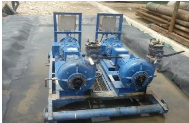
Fotografía 10. Bombas de transferencia de fluidos.
