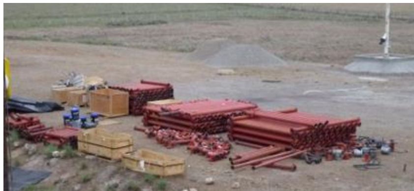
Fotografía 9. Tubería con uniones rápidas de golpe.
