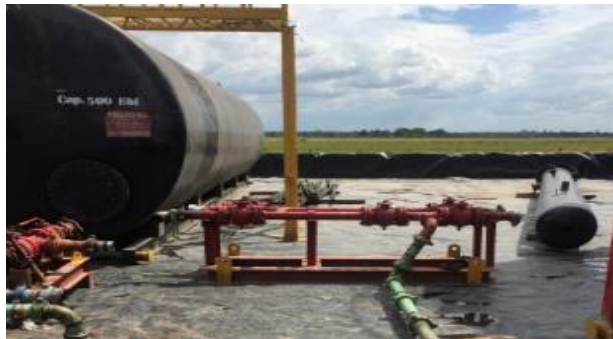
Fotografía 39. Facilidad para direccionar fluidos a diferentes puntos de facilidad (diverter), prefabricado.
