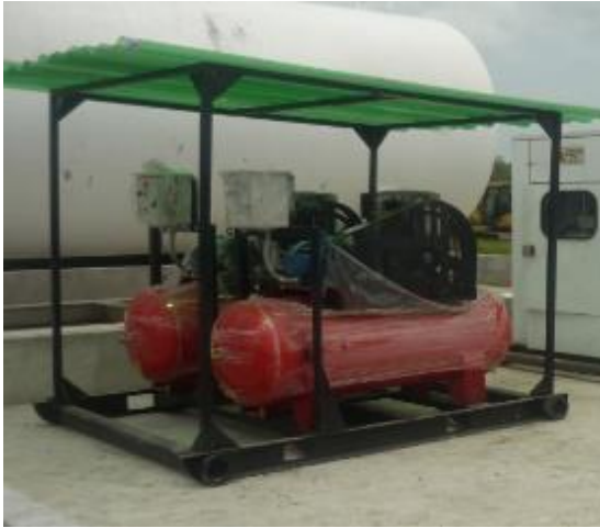
Fotografía 12. Compresores de aire.
