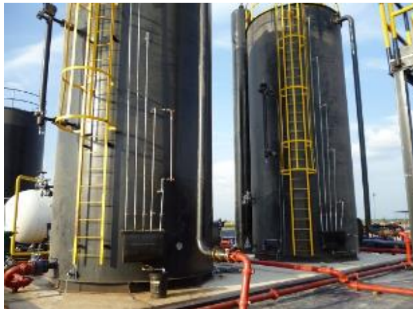
Fotografía 15. Tanques gun barrel.
