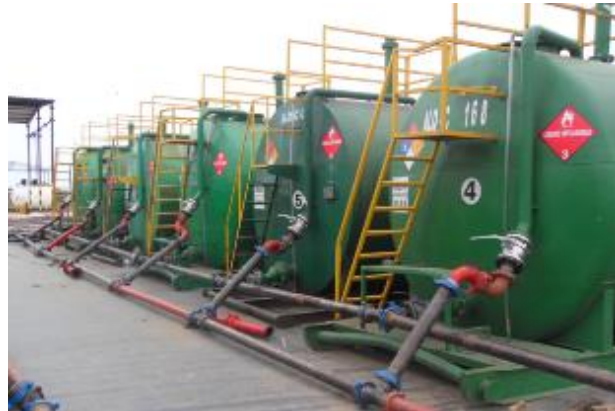
Fotografía 7. Tanques de almacenamiento de 500 bbl.
