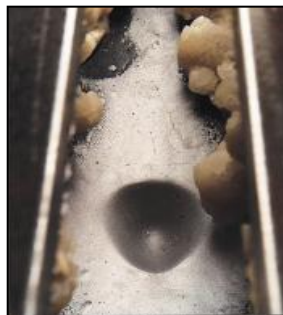
Figura 2.27. Eliminación de incrustaciones de carbonato de calcio con chorro de agua abrasivo.
