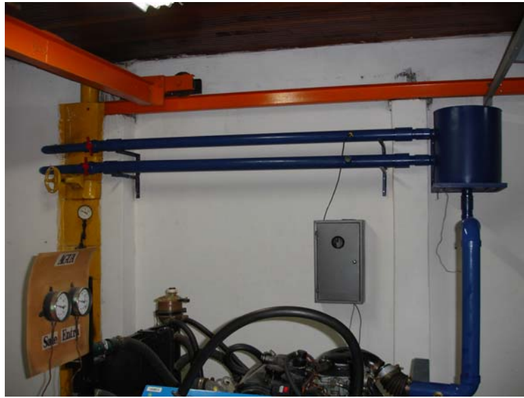
Figura 7. Tuberías aspiración de Aire
