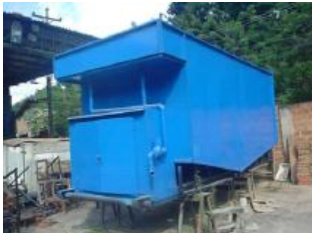
Figuras 20. Tanque de almacenamiento de aguas
