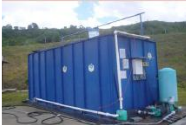
Figuras 21. Planta de tratamiento de aguas residuales
