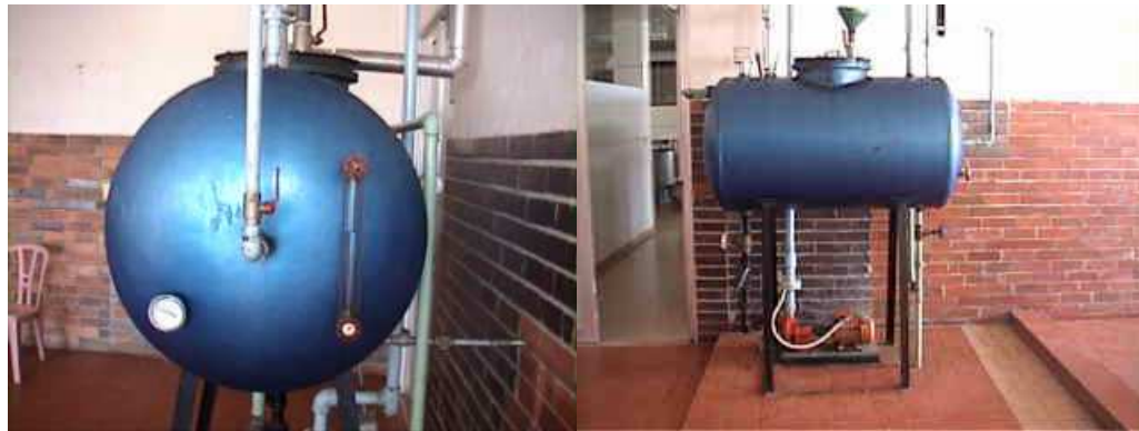
Figura 34. Tanque de condensado
