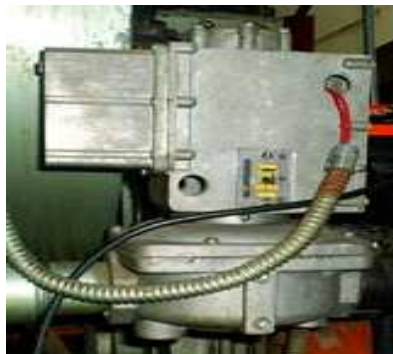
Figura 24. Válvula principal de combustible
