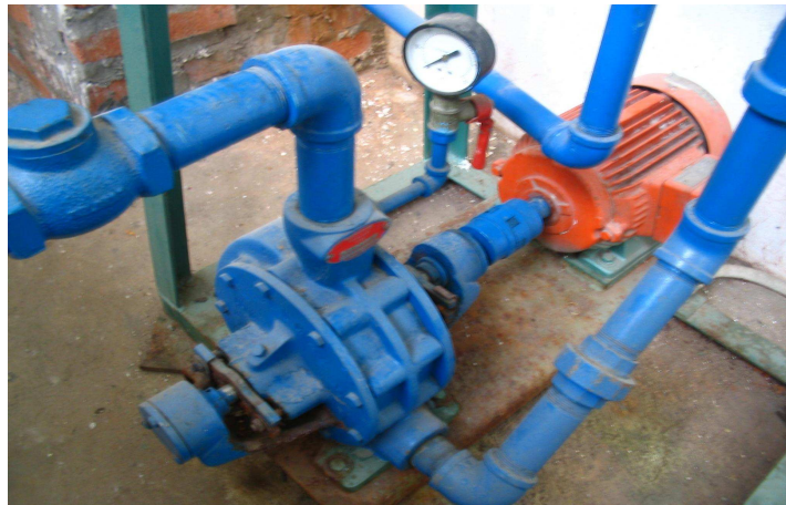
Figura 35. Bomba de alimentación
