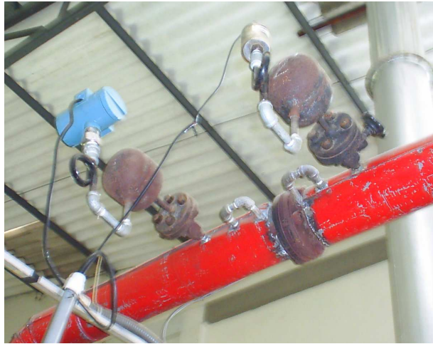
Figura 53. Transductores de presión
