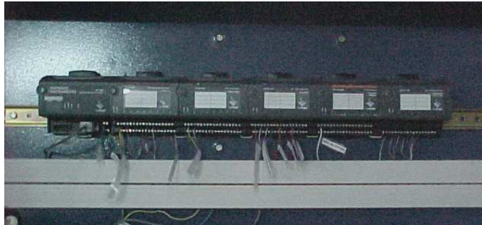
Figura 45. Banco de módulos fieldpoint utilizado en la caldera
