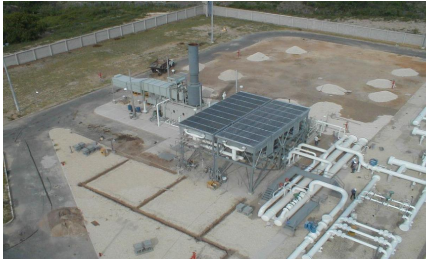
Imagen 4. Estación compresora tecnología centrífuga acople turbina
