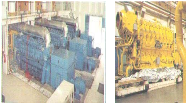
Figura 13. Motores a combustible dual marca Ruston Fuente: Manual Ruston, motores diesel, 2001.
