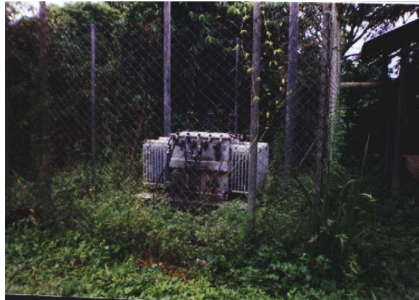
Fotografía 2. Transformador elevador 150 KVA.
