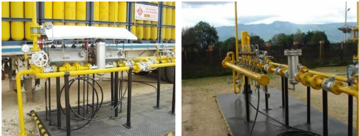
Figura 23. Estaciones de Descompresión de GNC
