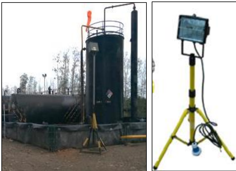
Figura 49. Iluminación tipo lámparas desmontables instaladas sobre trípodes
