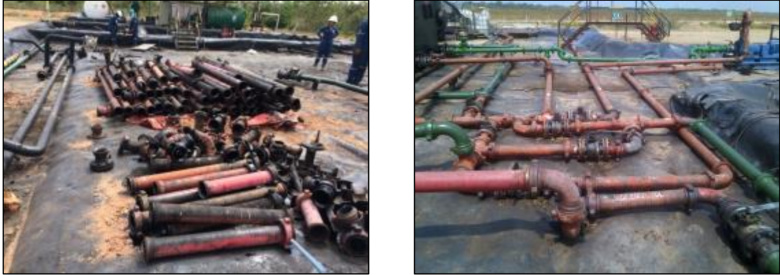
Figura 22. Fotografía conexión de componentes de well testing con tubería roscada tipo unión de Golpe de 4" figura 206
