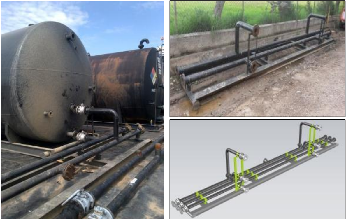
Figura 62. Skid colectores de entradas, salida y recirculación de tanques de almacenamiento de 500 Bls
