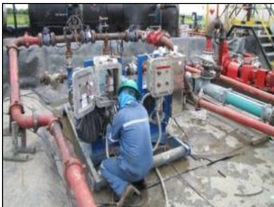
Figura 20. Fotografía cableado eléctrico
