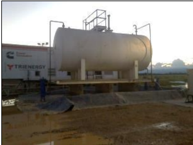
Figura 84. Tanque de diesel apoyado sobre soportes en concreto y dique construido en estructura metálica
