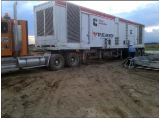
Figura 88. Trailer Generadores, compresores y Tablero de servicios generales
