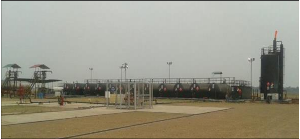
Figura 24. Fotografía equipo de Superficie para pruebas iniciales de Producción
