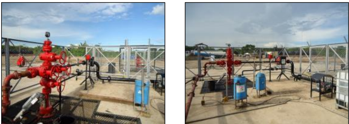
Figura 23. Fotografía Transición línea de flujo provisional en tubería roscada tipo unión de Golpe de 4" Figura 206 a línea definitiva construida rígidamente con cuadrillas calificadas de soldadura
