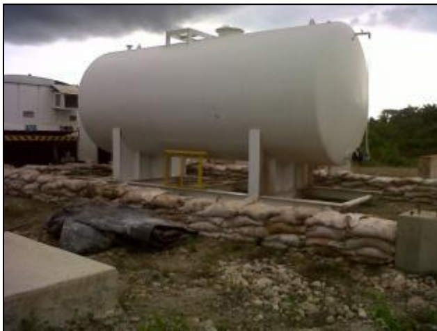
Figura 83. Tanque de Diesel a nivel de suelo y dique en saco-suelos
