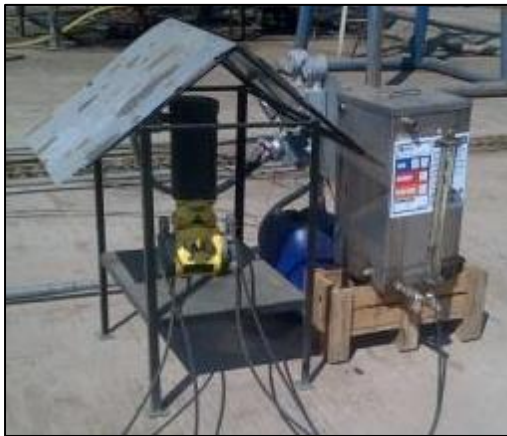
Figura 29. Bombas dosificadoras de química en cabeza de Pozo
