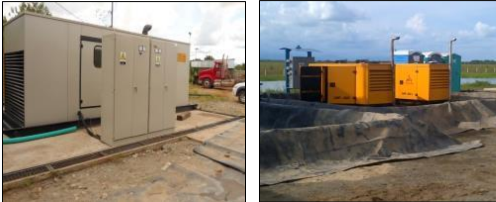
Figura 43. Generadores de 150 Kw
