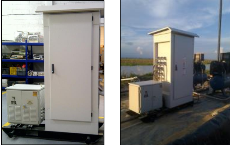
Figura 44. Tablero eléctrico de servicios generales convencional
