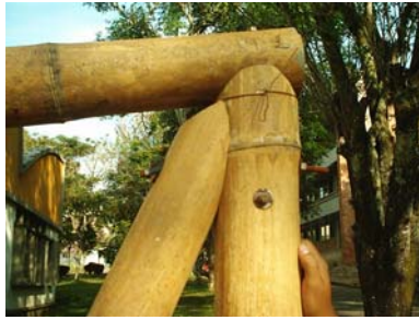
Fotografía 50. Desplazamiento de las uniones
