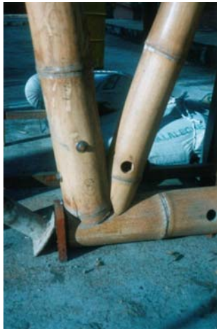
Fotografía 44. Apoyo contra deslizamiento
