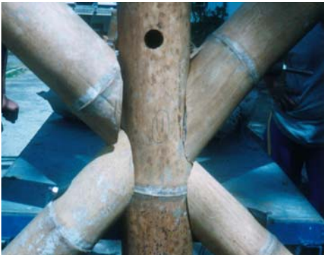
Fotografía 54. Punto 5 panel muro, pasador
