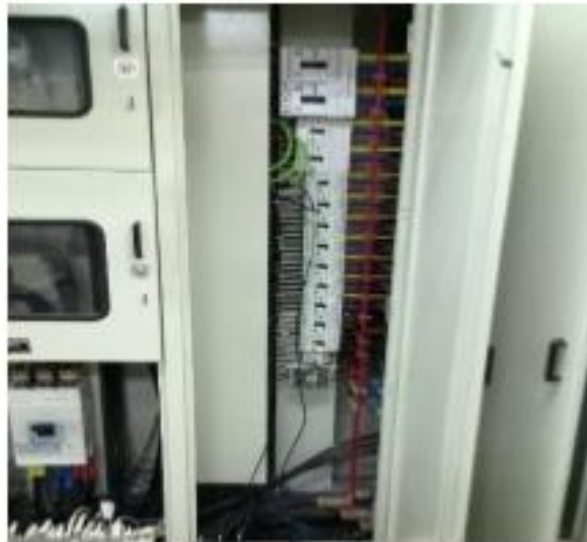
Figura 1. Tablero general de acometidas de biblioteca
