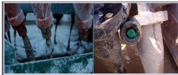
Figura 30. Obstrucción salida de Lodo-Hidrociclón.
