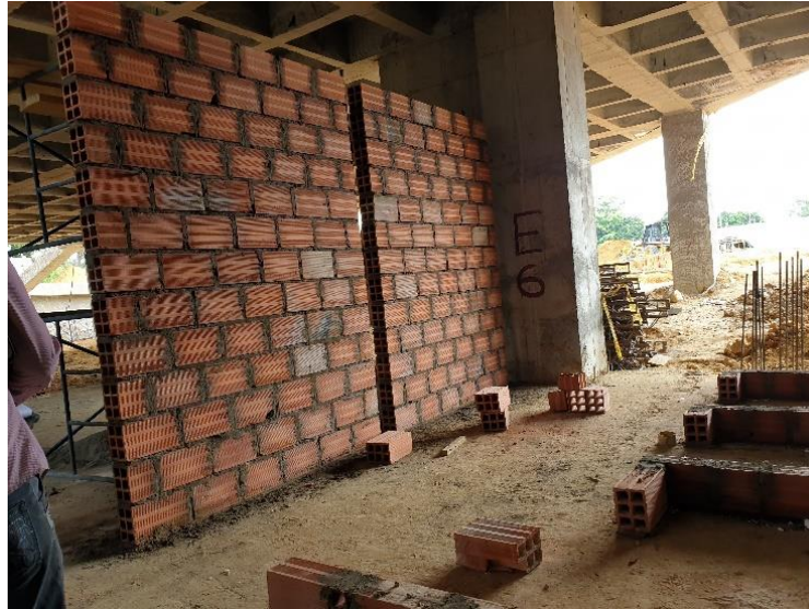
Figura 13. Mampostería demolida por inconsistencias en su alineación.
