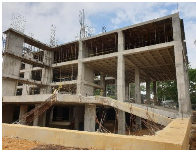
Figura 3. Estado placas aligeradas en empalme
