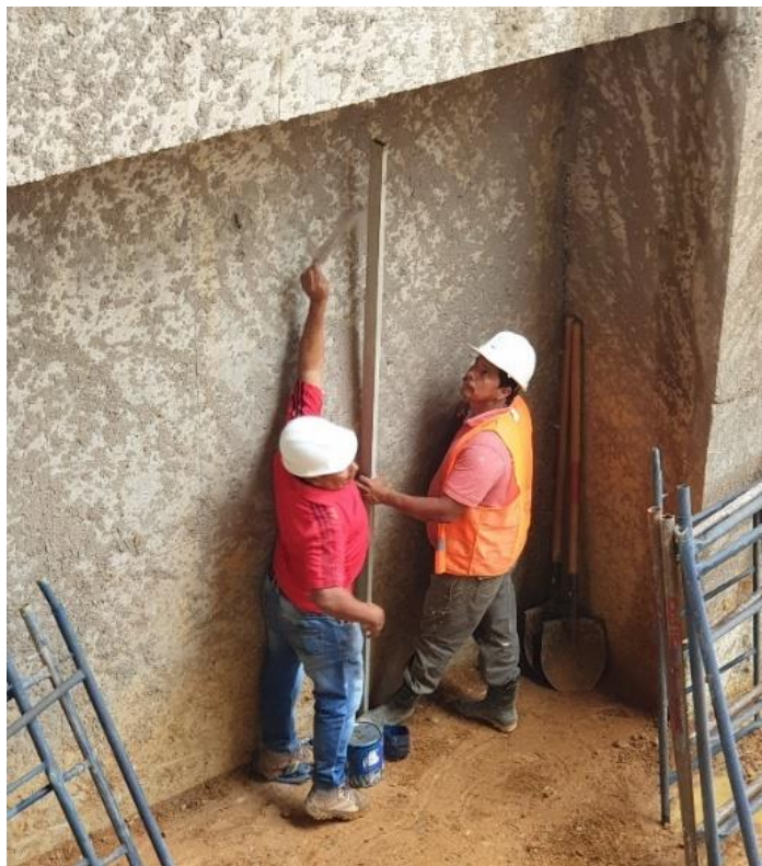
Figura 11. Muros de contención no alineados ni plomados.
