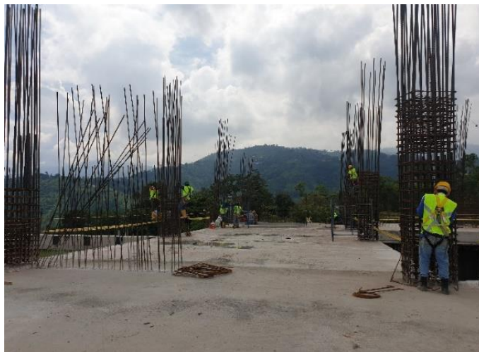
Figura 4. Estado de los elementos estructurales al momento de realizar balance de aceros de refuerzo.
