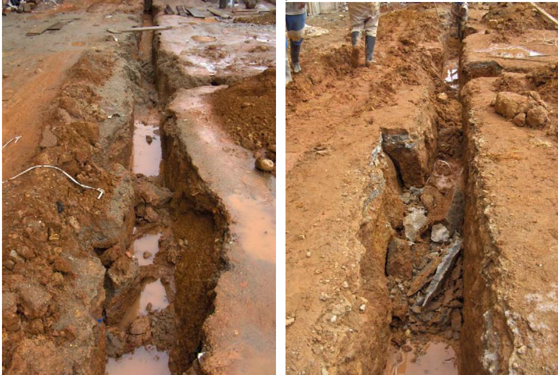
Figura 9. Deslizamientos dentro de la zanja de cimentación producidos por lluvias y tráfico peatonal y vehicular.
