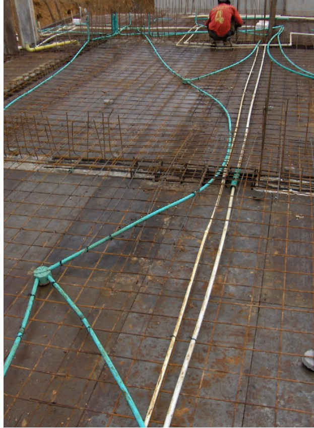
Figura 26. Curvatura de la tubería eléctrica para evitar fisuramiento de la placa
