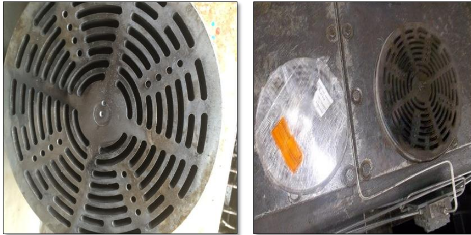
Figura 11. Válvulas de Succión y Descarga Compresor Ajax DPC-600
