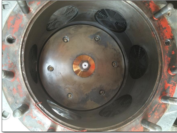
Figura 10. Cilindro del Compresor Ajax DPC-600
