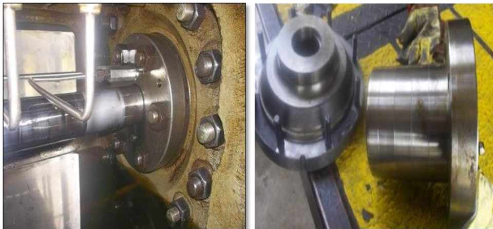
Figura 12. Empaquetadura de gas del Compresor Ajax DC-600.
