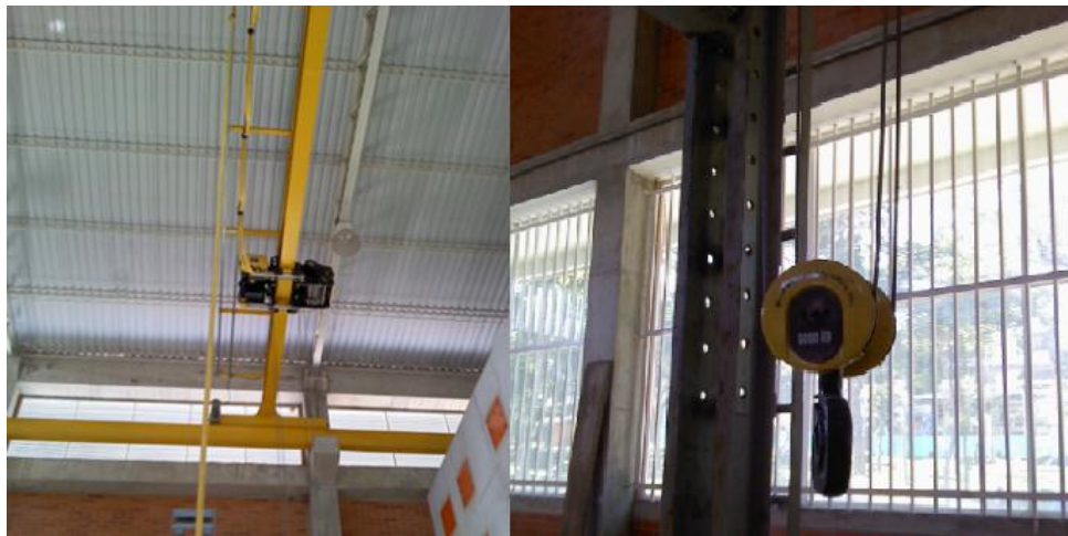
Figura 23. Puente Grúa con capacidad de 5000Kg
