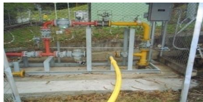
Gráfica 16. Válvulas de bloqueo y de seguridad
