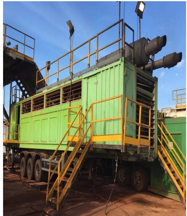
HPU (Unidad de Potencia Hidráulica)
