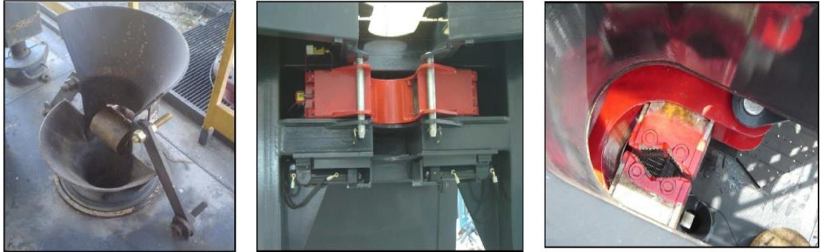
Figura 19. Equipos del mouse hole
