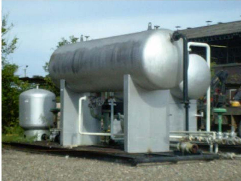
Figura 1.8 - Separadores de prueba fuera de servicio
