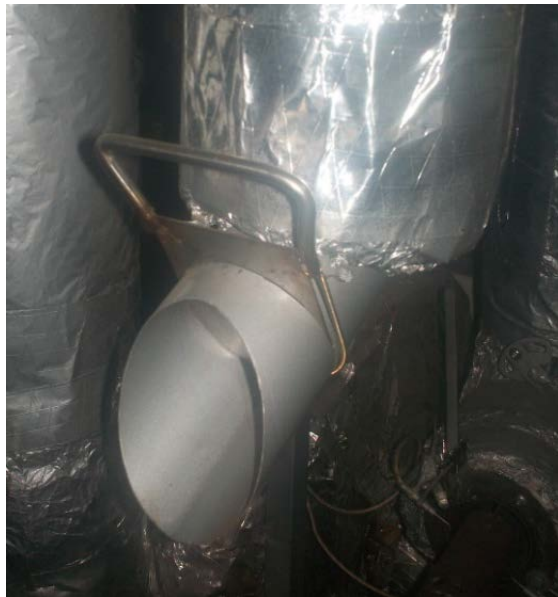
Figura 31. Compuerta trampa de partículas
