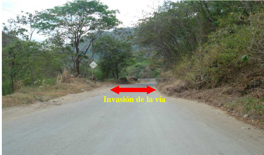
Fotografía 5. Deslizamiento horizontal margen derecho, ocasionando un embudo debido al río Unete ubicado al lado contrario, de la vía Aguazul-Guadalcanal.
