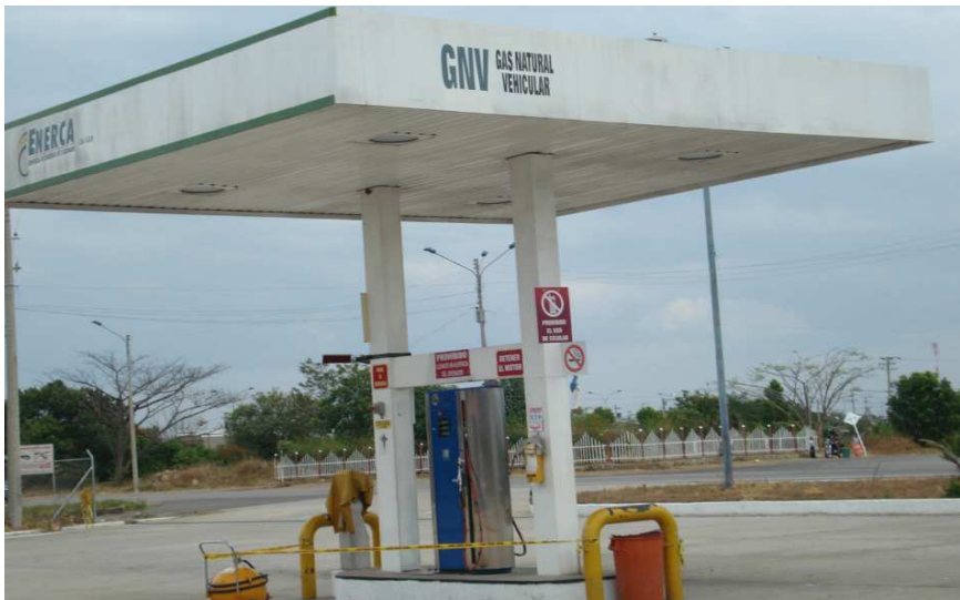
Fotografía 8. Planta de GNV de ENERCA SA ESP.
