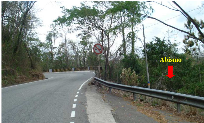
Fotografía 4. Abismo de 30 metros e inestabilidad a lado contrario, margen derecho vía Aguazul-Guadalcanal.
