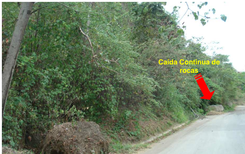
Fotografía 1. Rocas caídas por la continua erosión, margen derecho vía Aguazul-Guadacanal
