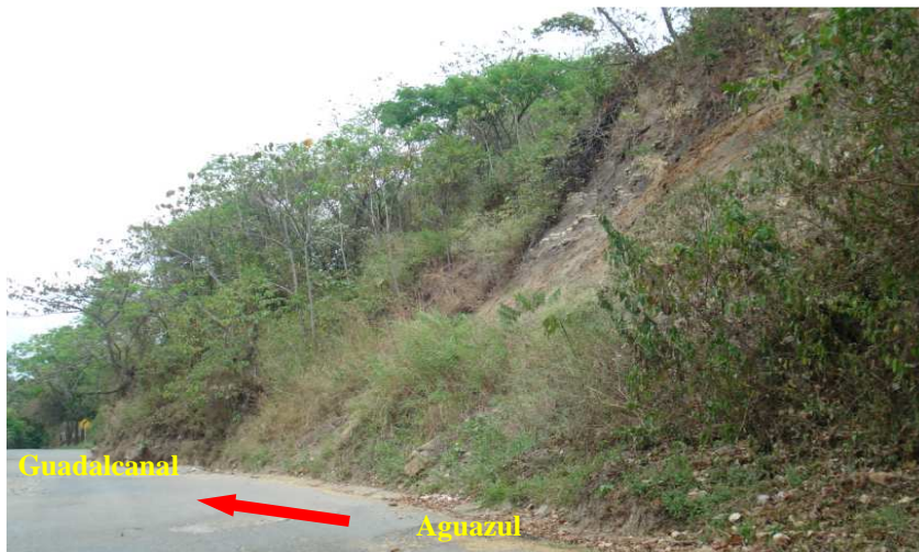
Fotografía 3. Deslizamiento vertical y horizontal, margen derecho de la vía Aguazul-Guadacanal.
