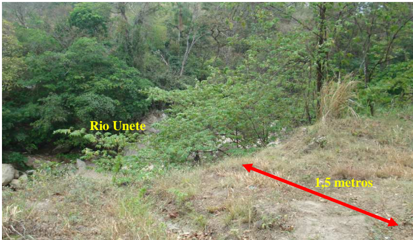
Fotografía 6. Socavación continua de la vía, margen izquierdo Aguazul-Guadalcanal.
