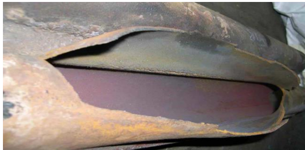
Figura 25. Falla por fatiga por corrosión en un tubo de caldera
