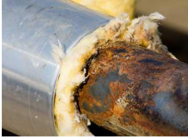
Figura 22 Corrosión bajo aislamiento
