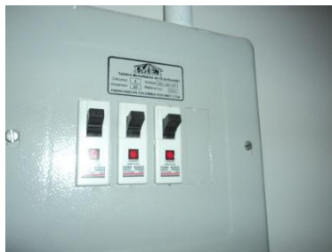
Figura 14. Barraje del Tablero TD
