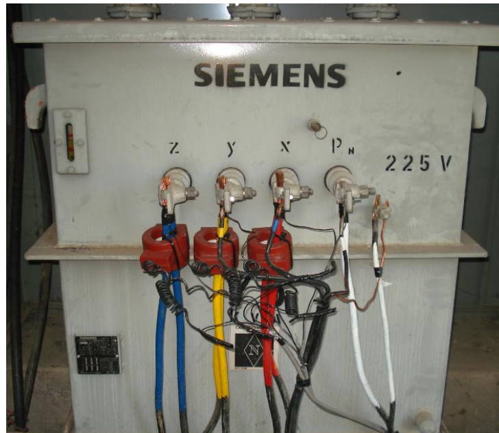
Figura 26. Trnasformador trifásico de 75kVA
