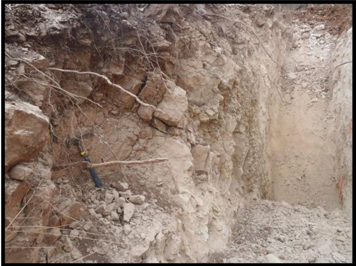
Figura 22: Fotografía del apique 30, que muestra la caliza perteneciente al G. Cogollo muy fracturada y diaclasada por el control estructural del área en estudio. Presencia de raíces.
