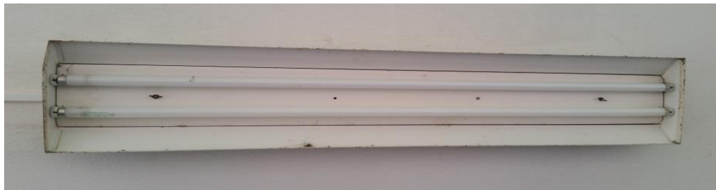
Figura 24. Plafón luminaria tipo tubo edificio FMB
