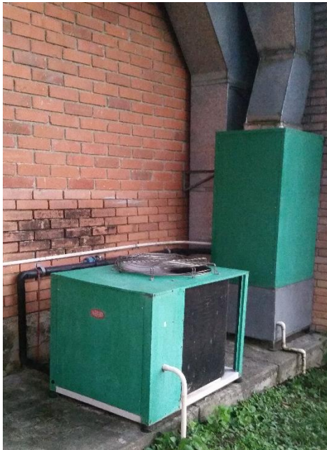
Figura 81. Aire acondicionado exterior edificio DC
