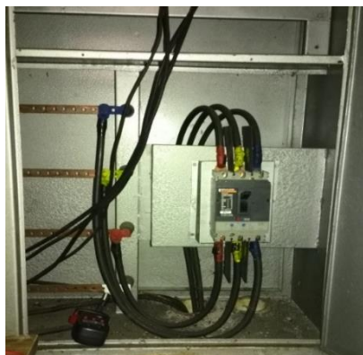
Figura 3. Acometida salón 111 edificio Federico Mamitza Bayer
