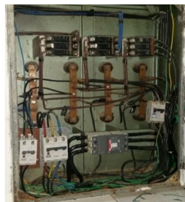
Figura 4. Tablero General 2 salón 105 edificio. Federico Mamitza Bayer
