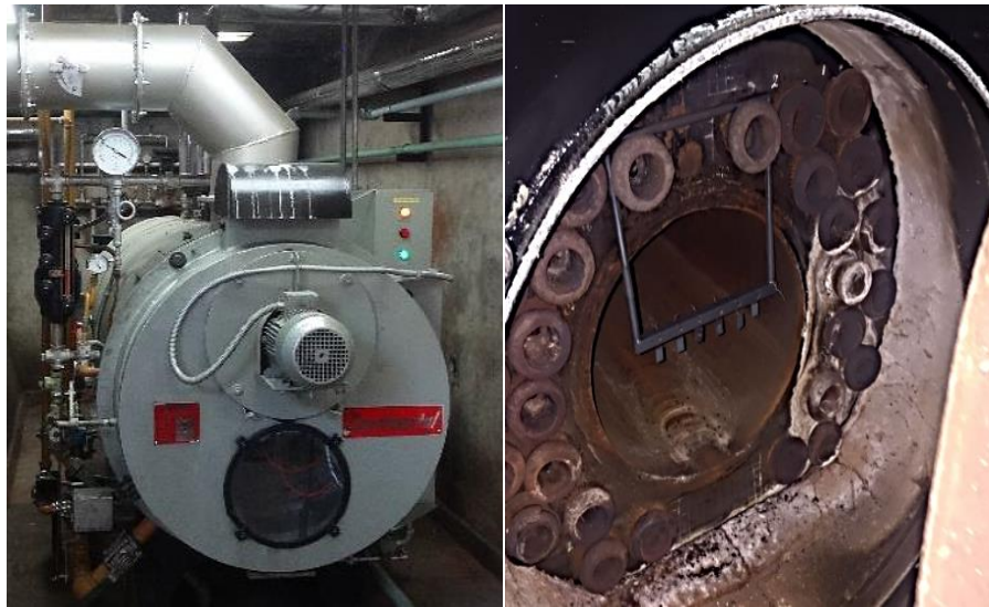
Figura 148. Caldera pirotubular y porta muestras utilizado para estudio de corrosión
