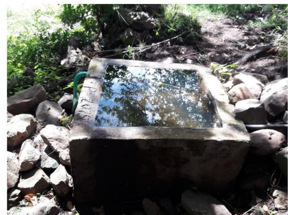
Foto 10. Tanque de almacenamiento sin cubierta
