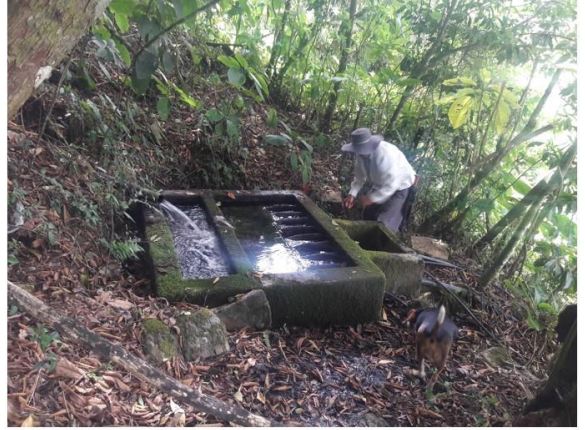
Foto 8. Afloramiento con tanque de distribución
