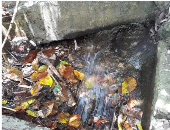
Foto 9. Contaminación por material orgánico
