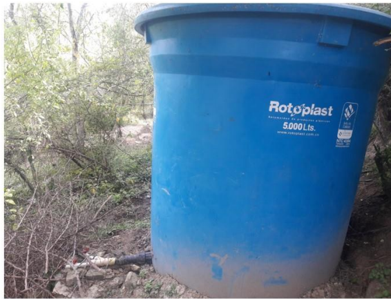
Foto 15. Tanque de almacenamiento con cubierta
