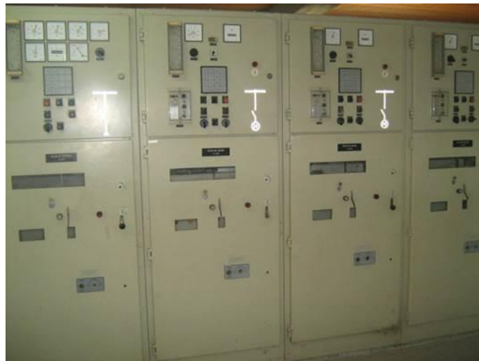
Figura 21. Tablero de Control en Media Tensión
