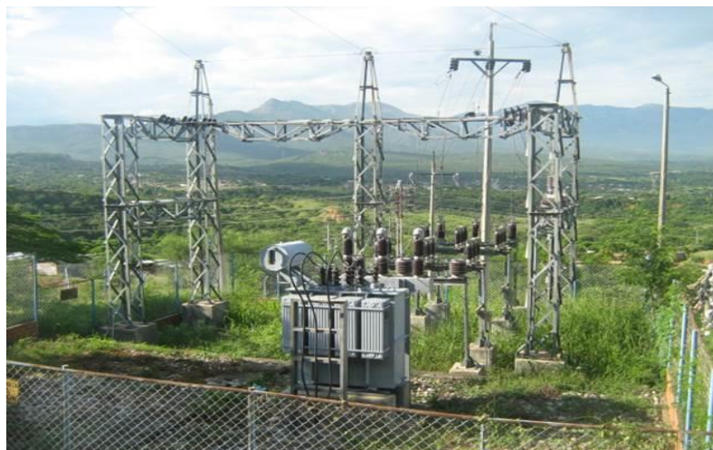
Figura 31. Registro Fotográfico Subestación Eléctrica Nidia.
