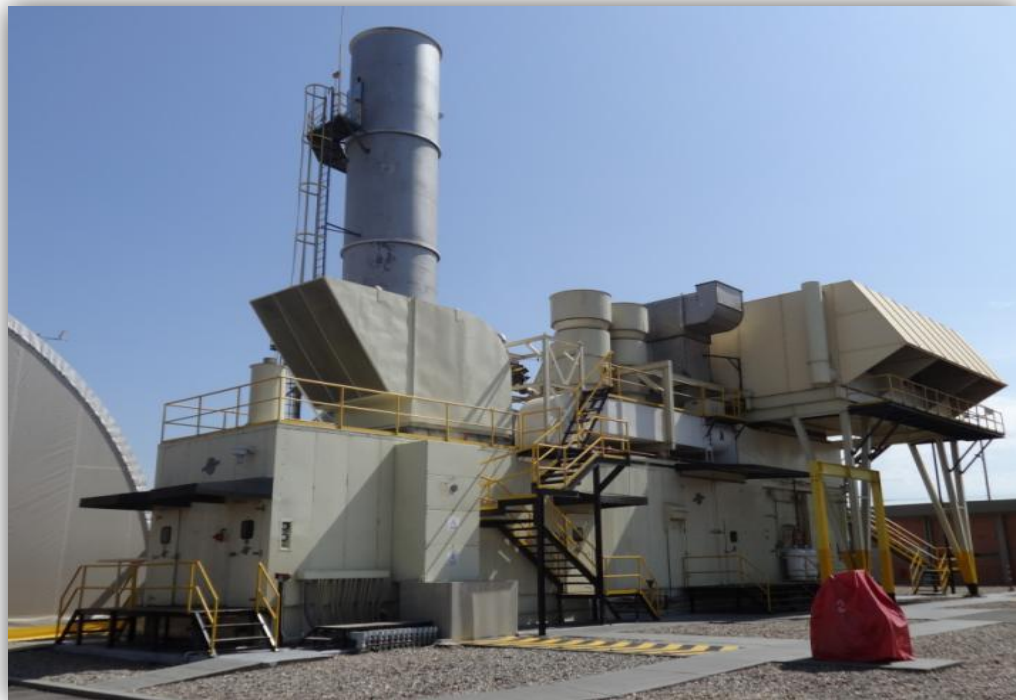
Figura. 44. Turbina de Gas LM6000PC
