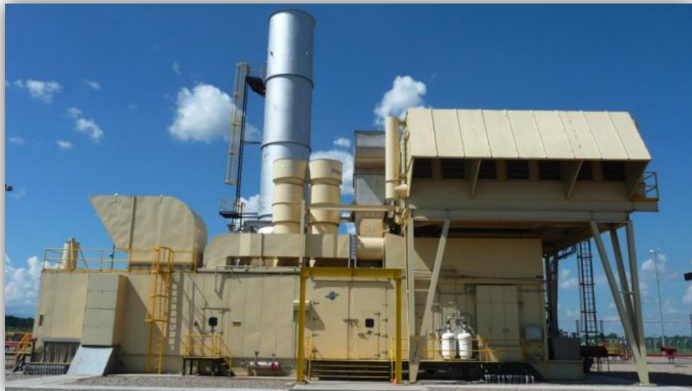
Figura. 13. Imagen Turbo Grupo Termoeléctrica de Suria Ecopetrol S.A
