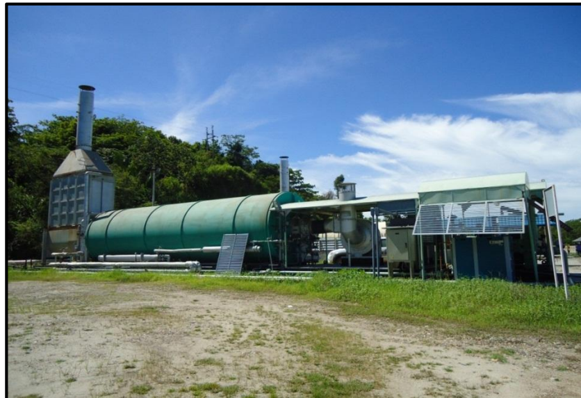
Figura 7. Generador de Vapor en Campo Jazmín.
