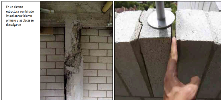
Figura 1. Daños en estructura de concreto
