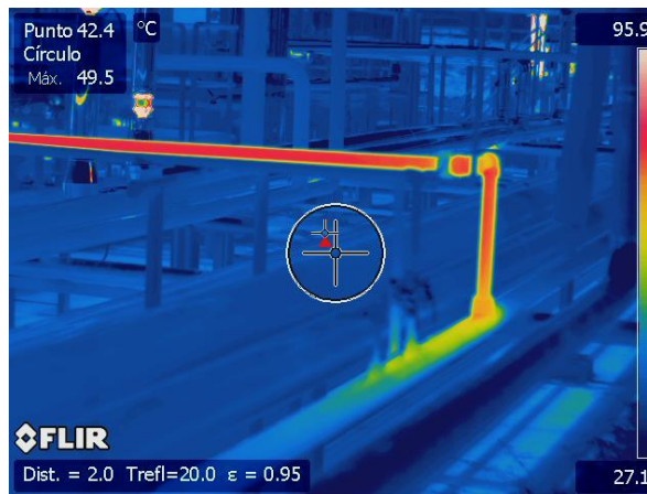
Figura 19. Termograma descarga a cabezal de stack
