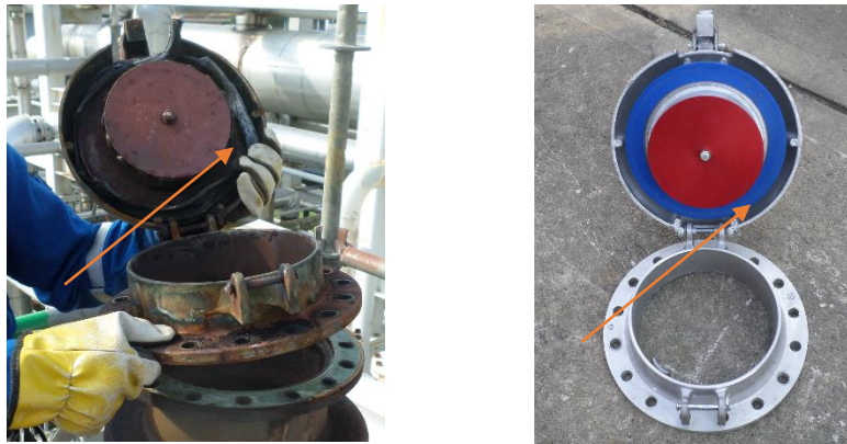
Figura 14. Falla en empaque de PSV (antes Vs. después)
