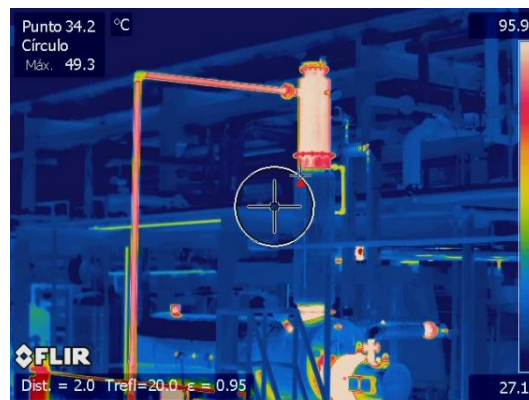
Figura 17. Termograma torre destiladora
