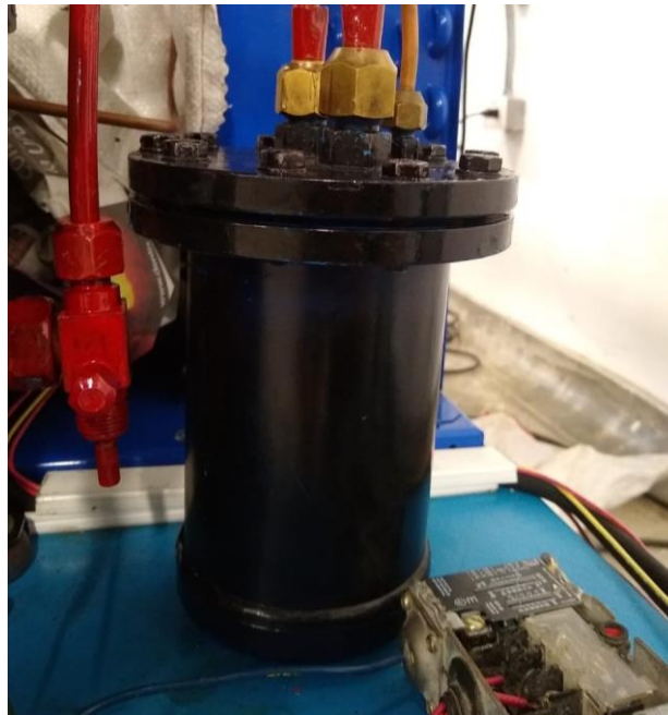
Figura 27. Separador de aceite del compresor de alta presión.
