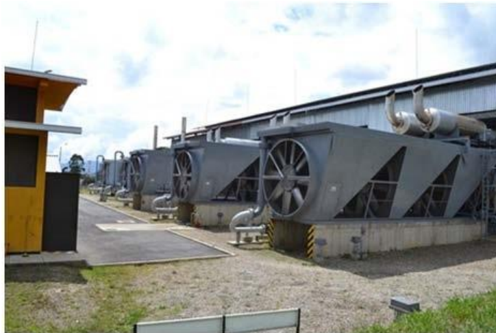
Fotografía 11. Estación Compresora Miraflores
