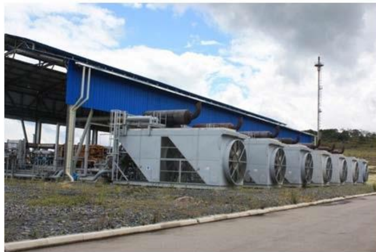
Fotografía 12. Estación Compresora Puente Guillermo
