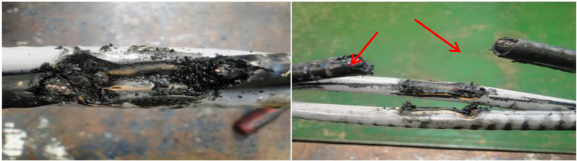
Figura 40 Daño del cable de POZO-4.
