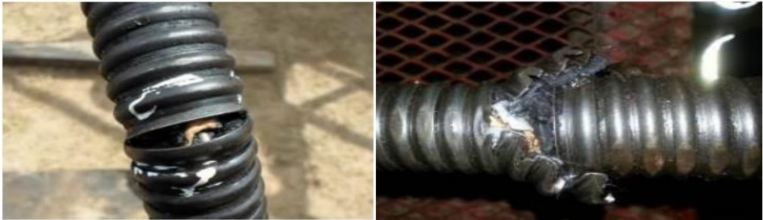
Figura 43. Daño del cable de POZO-5.
