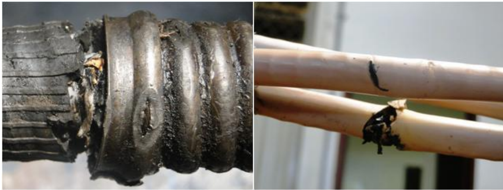
Figura 37. Daño del cable de POZO-3.
