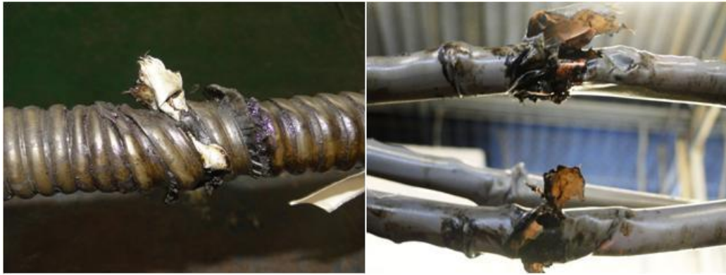
Figura 31. Daño del cable de POZO-1.
