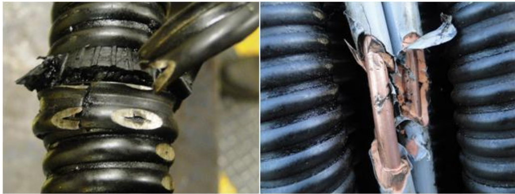
Figura 34. Daño del cable de POZO-2.
