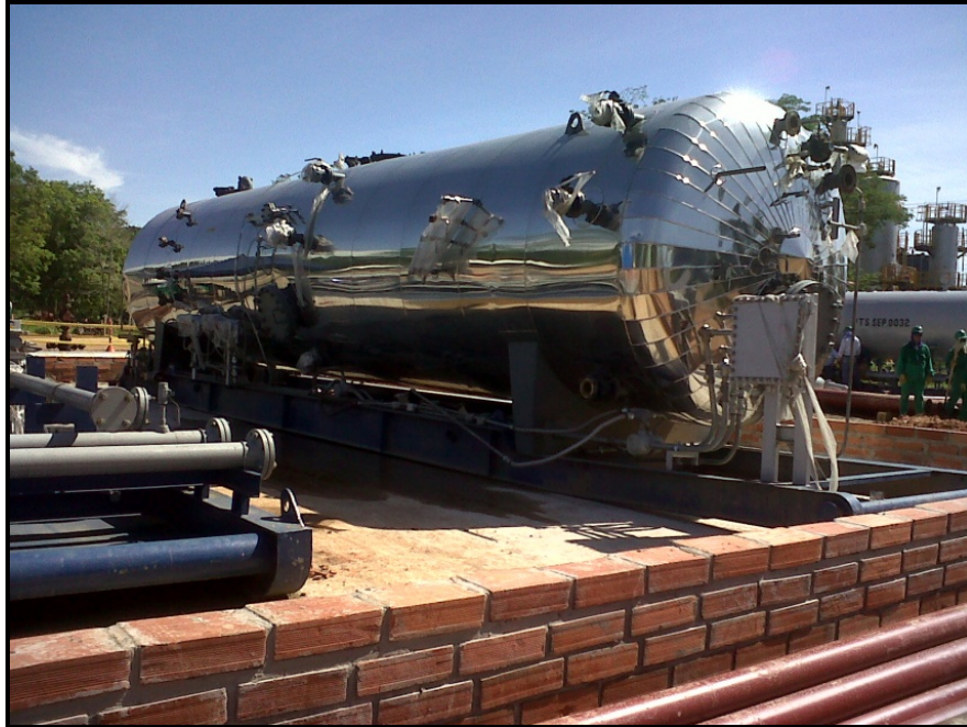
Figura 14 Estación de recolección y tratamiento PTS
