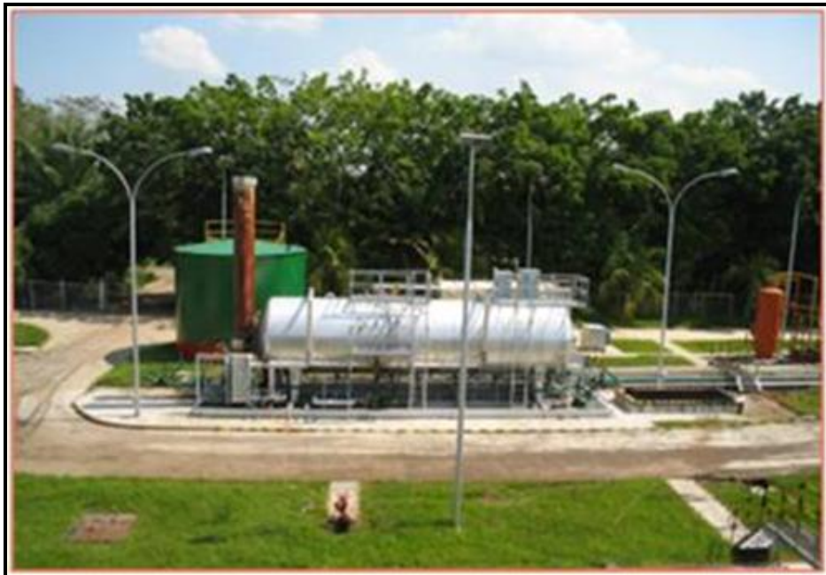
Figura 11 Estación de recolección y tratamiento 2
