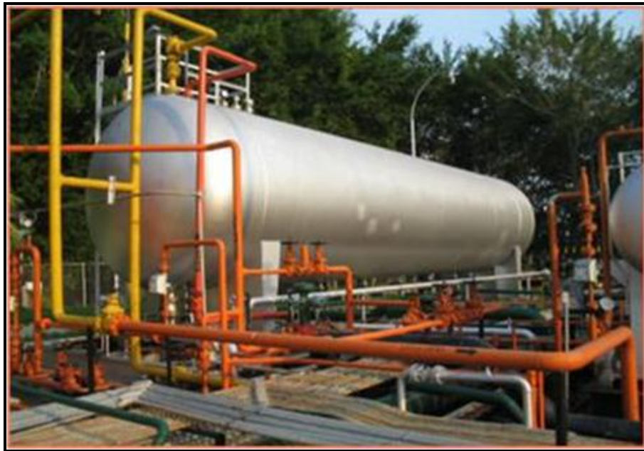
Figura 12 Estación de recolección y tratamiento 3
