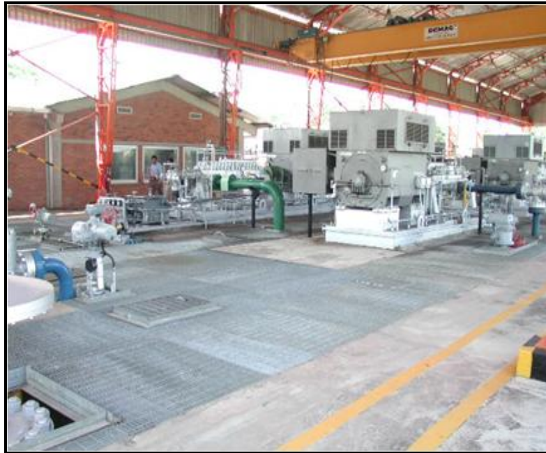
Figura 8 Planta de inyección
