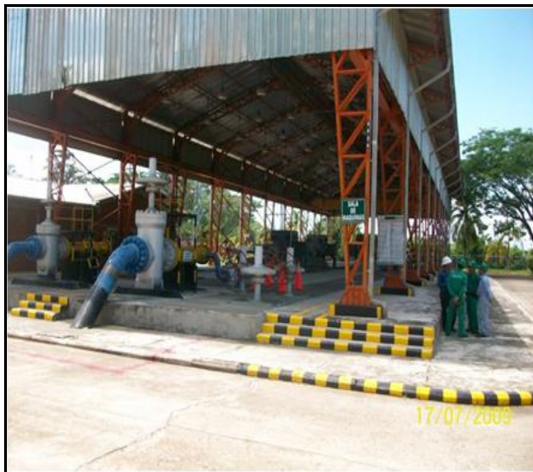
Figura 9 Planta de inyección
