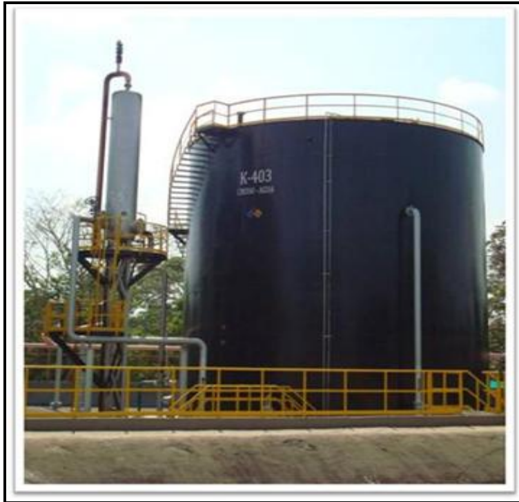
Figura 13 Estación de recolección y tratamiento 4
