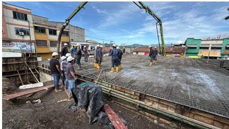
Figura 9. Acompañamiento de tercera visita a obra Remodelación del Parque Principal de San Vicente de Chucurí
