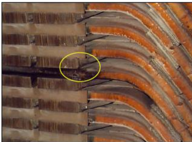
Figura 25. Falla en el aislamiento reconocida mediante una inspección visual
