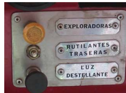
Fig. 53: Interruptores de luces de emergencia
