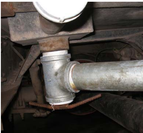
Fig. 15: Purga del tanque
