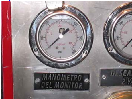
Fig. 61: Manómetro descarga lateral izquierda
