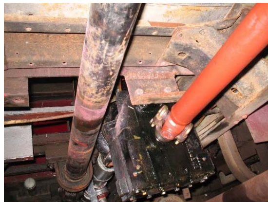
Fig. 46: Apoyo secundario de la bomba
