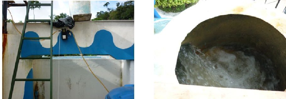
Imagen 2. Dosificación automatizada de PAC en mezcla rápida.
