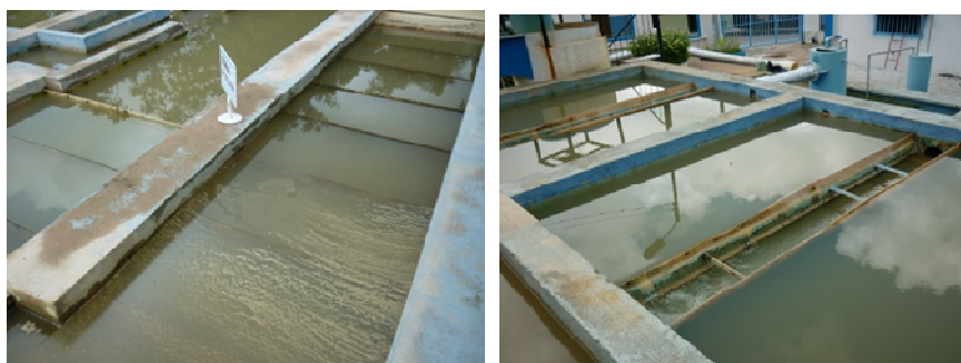
Imagen 6. Floculadores y Sedimentadores- agua floculando
