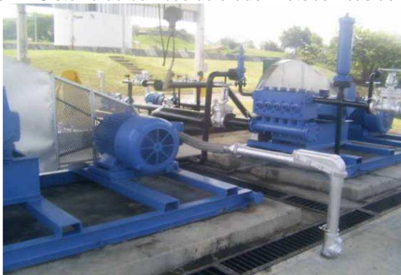
Fotografía 22. Sistema de bombeo de crudo. Motobombas de oleoducto.
