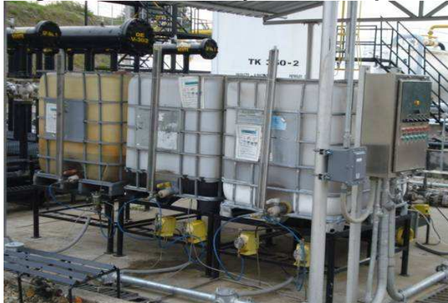
Fotografía 5. Patín de inyección de químicos.
