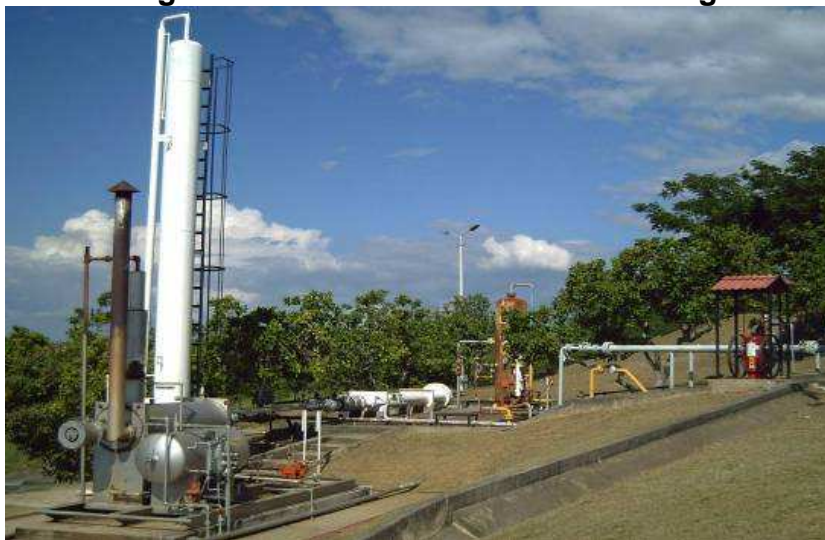
Fotografía 19. Planta deshidratadora de gas
