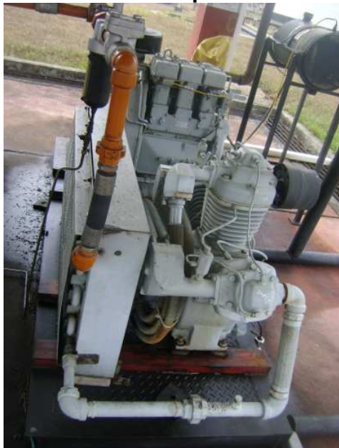
Fotografía 18. Motocompresor de aire diesel
