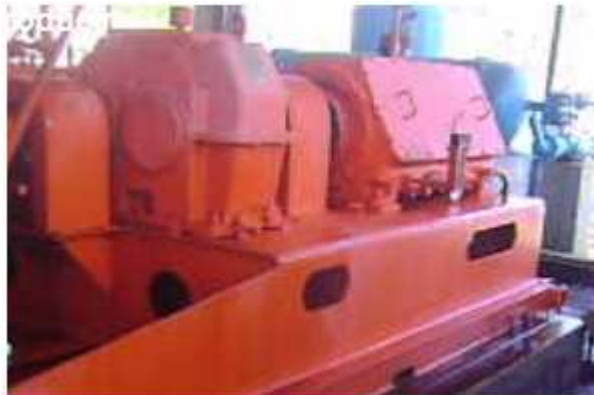
Fotografía 2. Bomba triplex de inyección de agua
