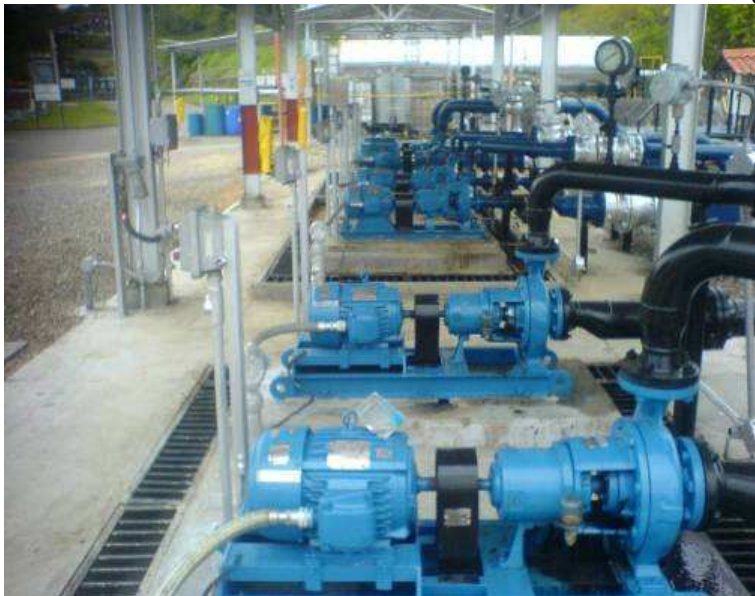
Fotografía 14. Caseta de motobombas de transferencia general
