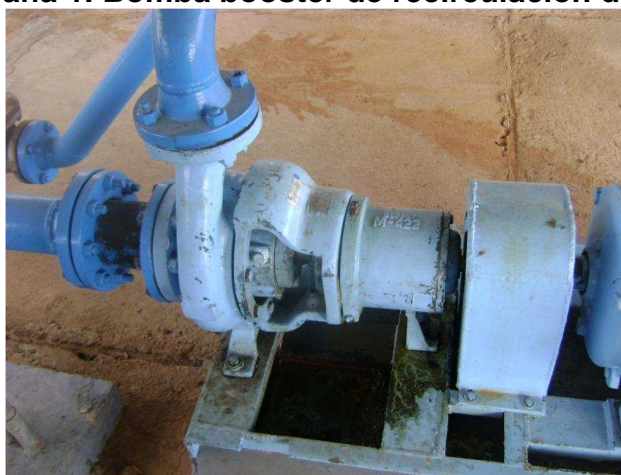
Fotografía 1. Bomba booster de recirculación de crudo
