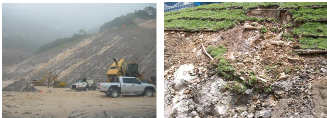
Fotografía 6. Izquierda: Imagen tomada durante evento de lluvia. Derecha: Empedrado dañado por desprendimiento de material del talud
