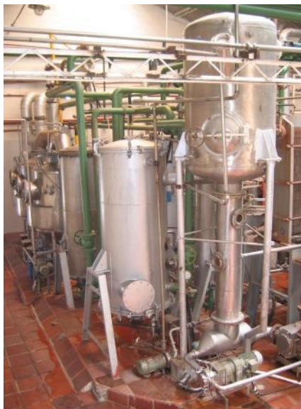
Figura 5. Imágenes del tanque concentrador
