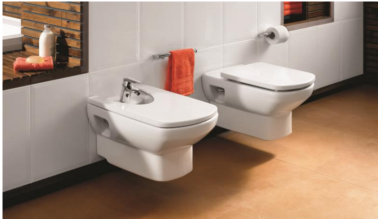
Figura 50. Bidet suspendido Dama Senso Roca instalado
