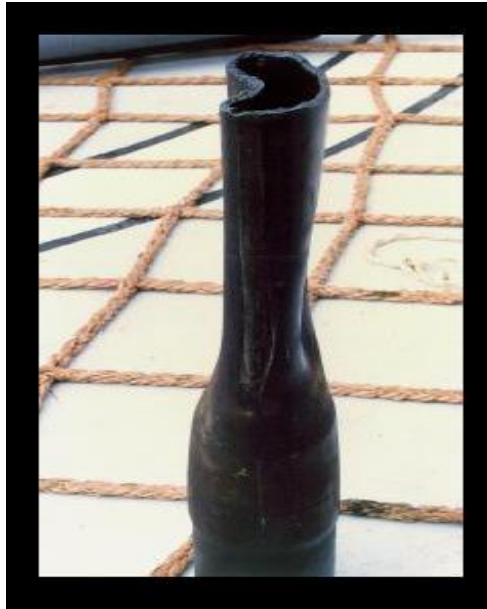
Figura 39. Efecto del colapso en tubería.
