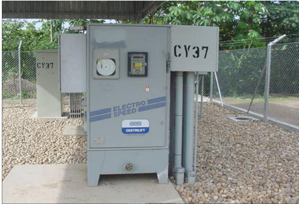
Figura 15. Controlador de frecuencia.
