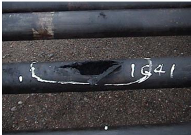
c. Tubería rota por acción del gas y el rozamiento
