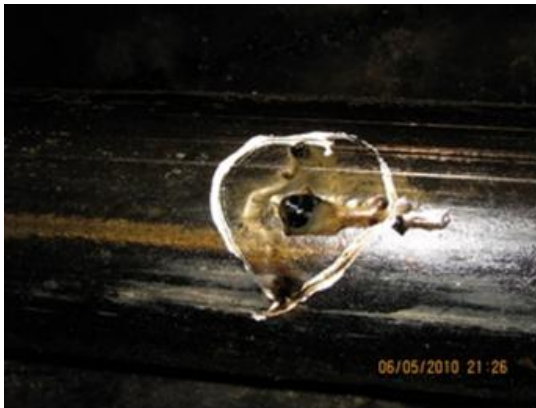
b. Blas Joint perforado por la acción del gas
