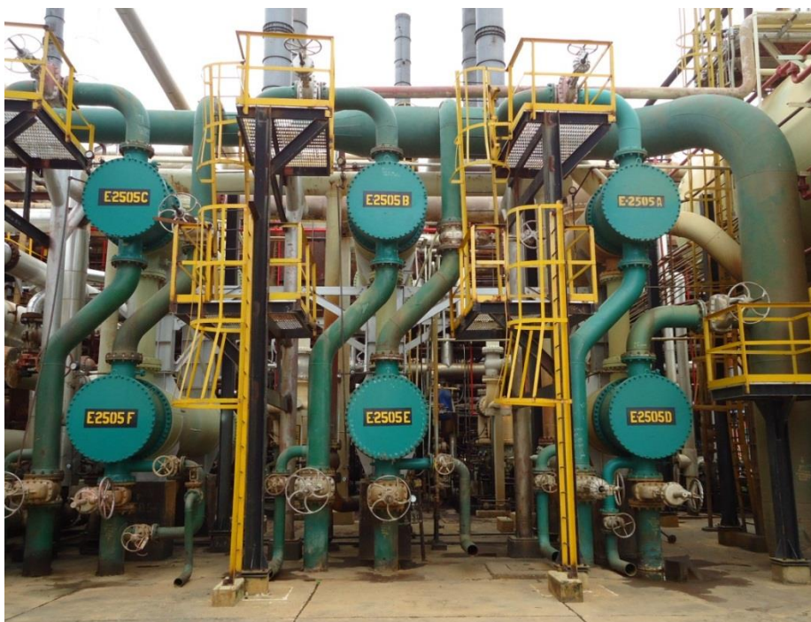
Intercambiadores de calor SE-2505 A-F.
