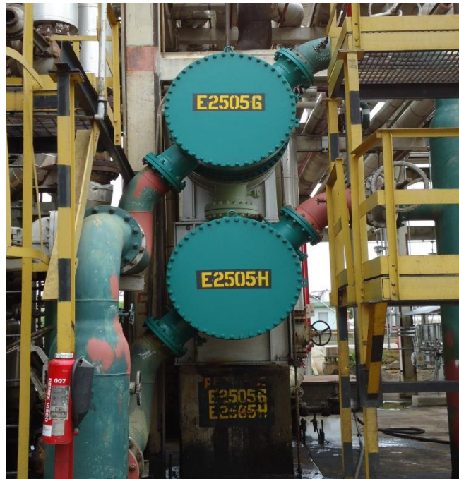
Intercambiadores de calor SE-2505 G-H.
