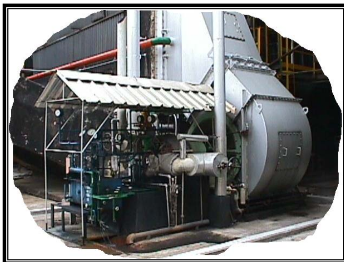
Figura 28. Ventilador de tiro forzado (Caldera).
