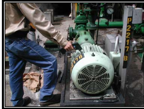
Figura 57. Medición de temperatura en un motor eléctrico.
