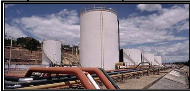
Figura 5. Tanques de almacenamiento y tuberías de transporte.
